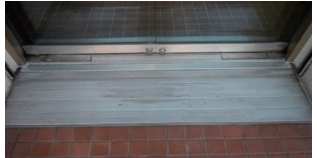
溝付き金属製下地 (泥落とし) の一部をカットしてコの字型のアルミバーを取付。
